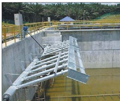
Ilustracja 7. Napęd ze zmienną prędkością obrotową zamontowany na wirówce sedymentacyjnej w oczyszczalni ścieków
