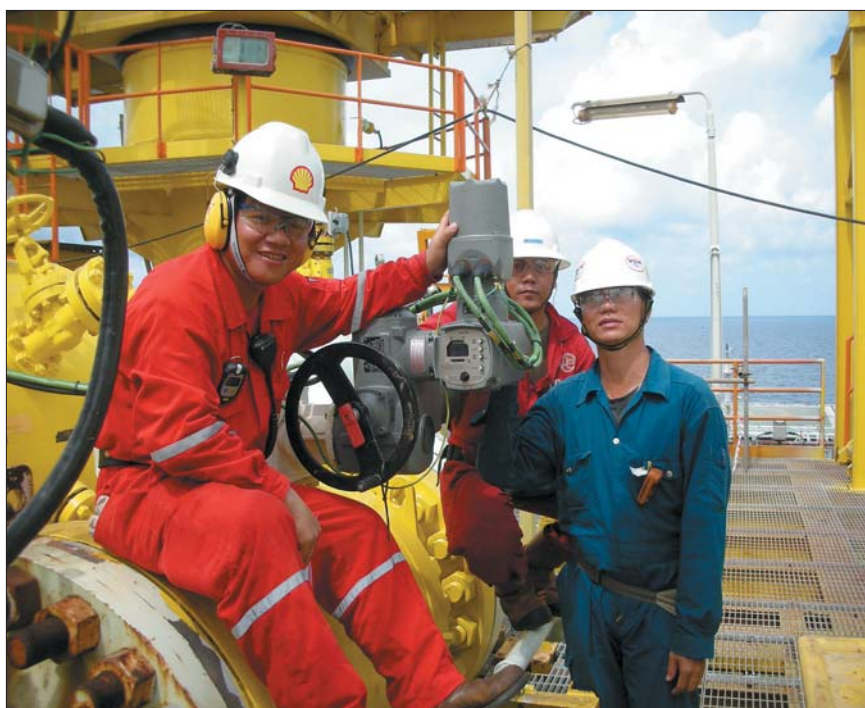
Ilustracja 1. Napęd zamontowany na platformie wiertniczej na Morzu Południowochińskim
