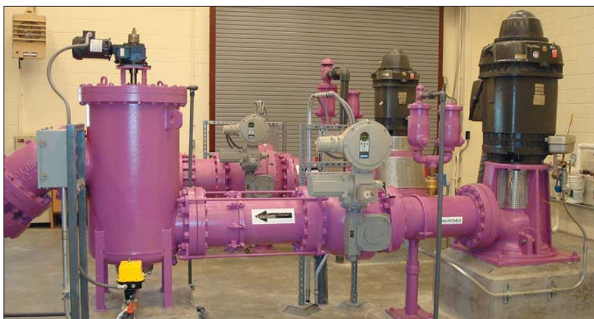
Ilustracja 6. Projekt odzyskiwania wody North Water w gminie Erie jest jedną z najnowszych instalacji, które świadczą o profesjonalnej realizacji projektu przez firmę Pipestone Equipment – również w zakresie inteligentnego zastosowania napędów SIPOS
