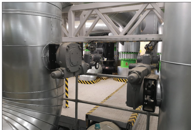
Zdjęcie 1. Automatyzacja komory ciepłowniczej AUMA AC – komunikacja Modbus RTU
