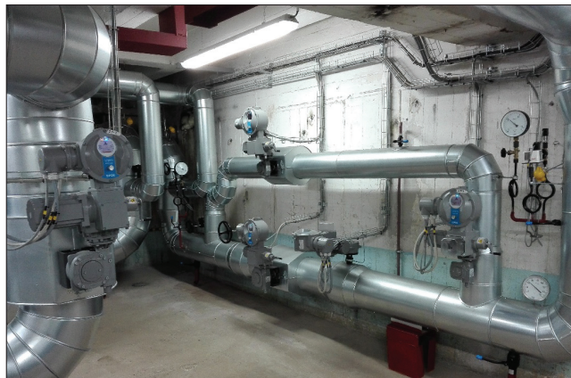
Zdjęcie 2. Automatyzacja komory ciepłowniczej AUMA SEVEN
