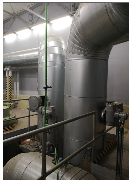
Zdjęcie 3. Automatyzacja komory ciepłowniczej AUMA AC – komunikacja Modbus RTU
