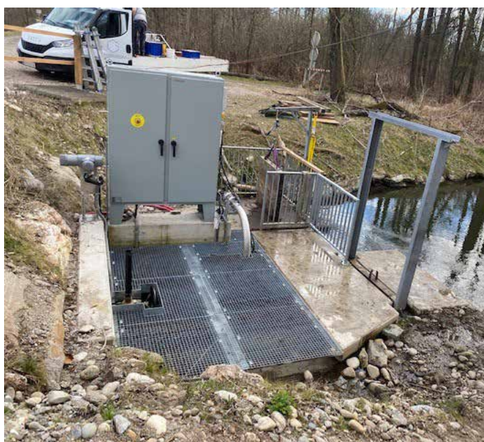
Gut getarntes Wasserkraftwerk: Im normalen Betrieb befinden sich Stellantrieb und Turbine unter Wasser. Hinten links ist die AUMA Stellantriebs-Steuerung ACV 01.2 zu sehen, die getrennt vom Stellantrieb oberhalb des Schachts montiert ist.
